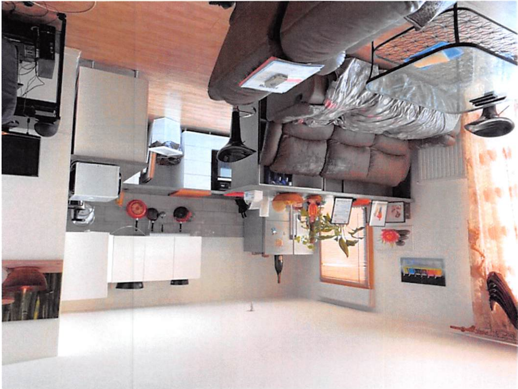
La pièce est ventilée par une VMC.
