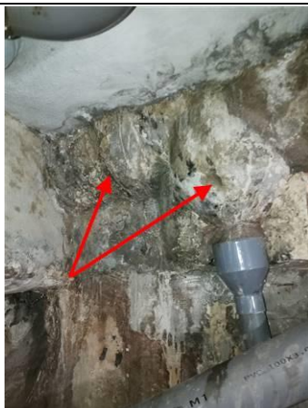
Photo n° PhA002 Localisation : Cave (plafond) Ouvrage : Conduits de fluides (air, eau, autres fluides) Partie d'ouvrage : Conduits Description : Conduit de fumée amiante ciment Localisation sur croquis : M002
