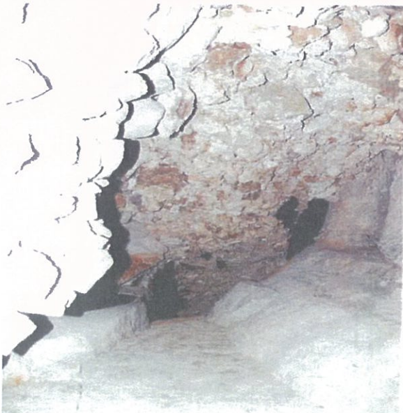
Fontis ancien permettant le passage dans l'étage supérieur effondré
