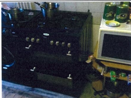
Photo n° PhGaz003 Localisation : Cuisine Cuisinière BEKO (Type : Non raccordé)
