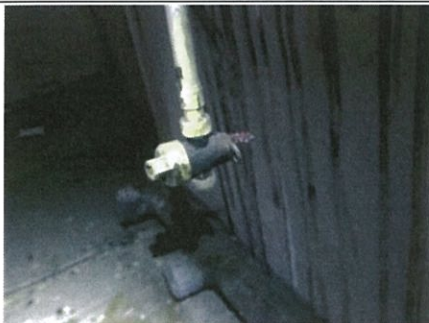
Photo n° PhGaz001 Localisation : Pièce Robinet en attente (Type : )
