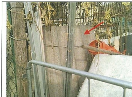
Photo n° PhA001 Localisation : Parties extérieures Ouvrage : 1 - Couvertures, Toitures, Terrasses et étanchéités - Plaques ondulées et planes Partie d'ouvrage : Plaques en fibres-ciment (y compris plaques « sous tuiles ») Description : Plaques en fibres-ciment (y compris plaques « sous tuiles »)
