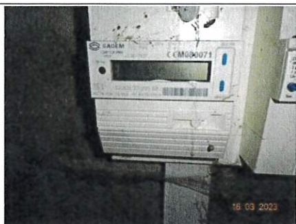
Photo du Compteur électrique
