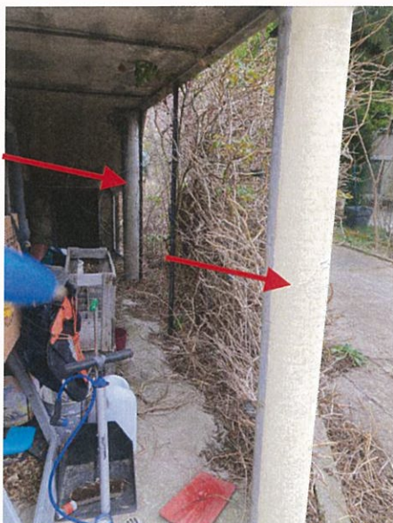
Coffrages perdus amiante-ciment sous entrée app.2
