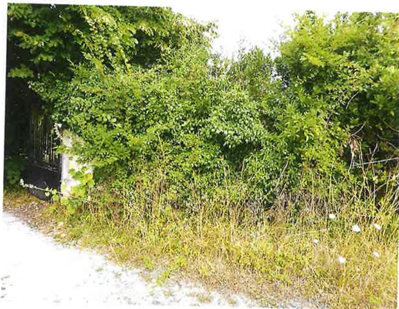
Pilier droit du portail couvert de végétation
