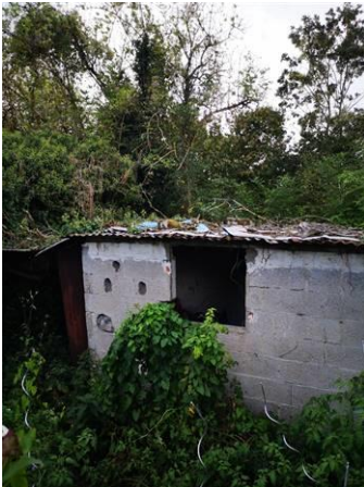
Photo n° PhTer003 Localisation : Jardin non attenant - Abri de jardin Ouvrage : Charpente - Bois Parasite : ---- Insectes à larves xylophages ----, Champignon de pourriture cubique du type lenzite des poutres (Gloeophyllum trabeum)(situé en extérieur) Indices : dégradation du bois (présence étendue), dégradation du bois (présence sur une partie de l'élément)
