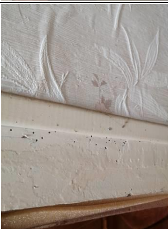
Photo n° PhTer001 Localisation : 1er étage - Chambre 1 Ouvrage Poutres - Bois et Peinture Parasite : Anobium punctatum (Petites vrillettes) Indices : présence de trous de sortie (présence sur une partie de l'élément)
