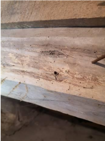
Photo n° PhTer002 Localisation : Combles - Combles 1 Ouvrage : Charpente - Bois Parasite : Anobium punctatum (Petites vrillettes) Indices : présence de trous de sortie (présence sur une partie de l'élément)
