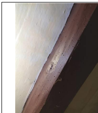
Photo n° PhTer001 Localisation : 1er étage - Chambre 1 Ouvrage : Poutres - Bois et Peinture Parasite : Anobium punctatum (Petites vrillettes) Indices : présence de trous de sortie (présence sur une partie de l'élément)
