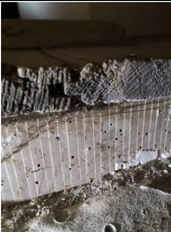
Photo n° PhTer002 Localisation : Combles - Combles 1 Ouvrage : Sol - Plancher bois et chape sèche Parasite : Anobium punctatum (Petites vrillettes) Indices : présence de trous de sortie (présence sur une partie de l'élément)
