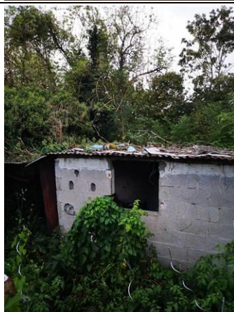
Photo n° PhTer003 Localisation : Jardin non attenant - Abri de jardin Ouvrage : Charpente - Bois Parasite : ---- Insectes à larves xylophages ----, Champignon de pourriture cubique du type lenzite des poutres ( Gloeophyllum trabeum )(situé en extérieur) Indices : dégradation du bois (présence étendue), dégradation du bois (présence sur une partie de l'élément)
