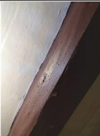
Photo n° PhTer001 Localisation : 1er étage - Chambre 1 Poutres - Bois et Peinture Parasite : Anobium punctatum (Petites vrillettes) Indices : présence de trous de sortie (présence sur une partie de l'élément)
