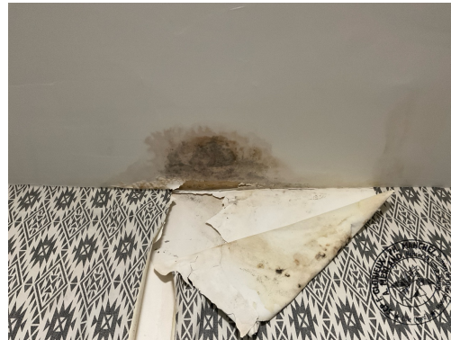
45. Trace d'humidité sur le plafond
