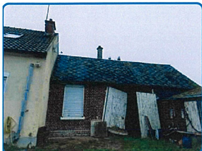
Toiture Accessoires amiante ciment (dans Dépendance n°1 EXTERIEUR DEPENDANCE)
