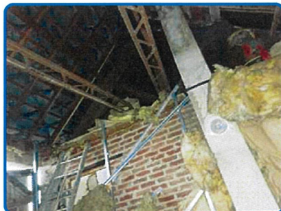
Plafond Sous face de la couverture Amiante ciment (dans Dépendance n°1 EXTERIEUR Grange)
