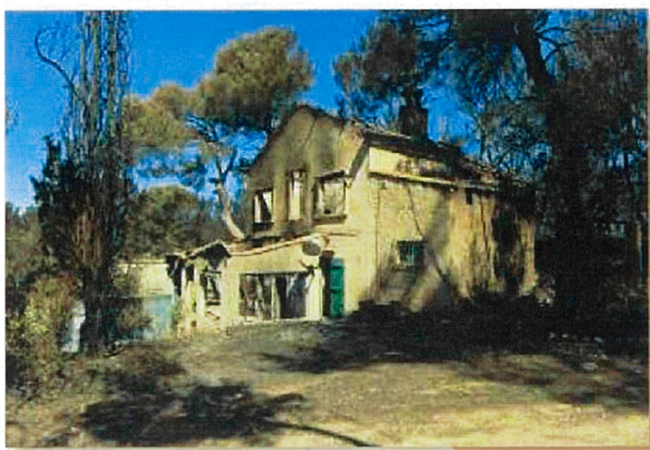
Maison non débroussaillée partiellement détruite par le passage d'un feu, Regnac (13) - source : ONF
