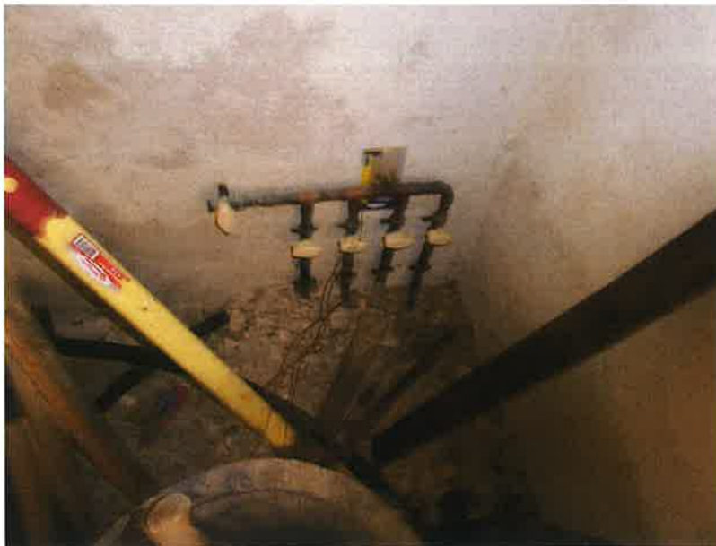
La pompe de relevage.
