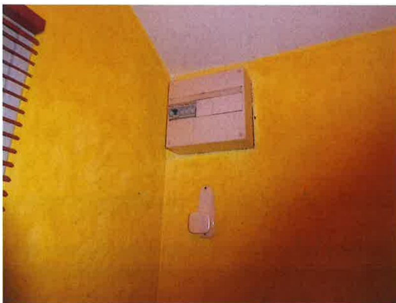
Un tableau électrique.
