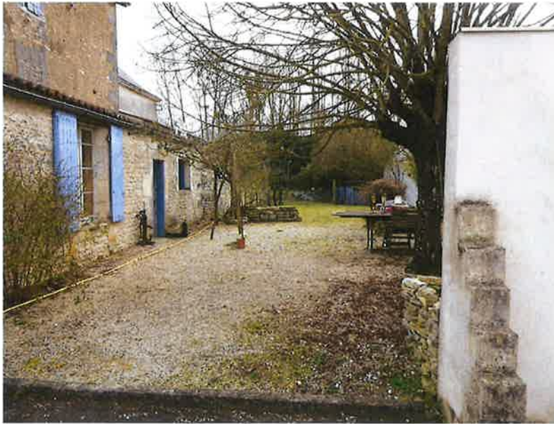
En partie haute, la façade arrière de la maison est recouverte d'enduits anciens.
