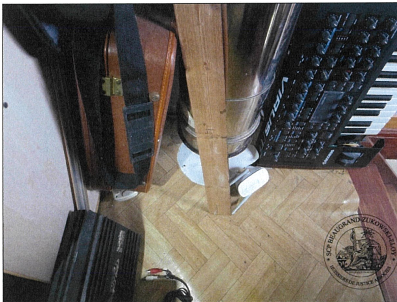
Photographie n°10. Tube de chauffage
