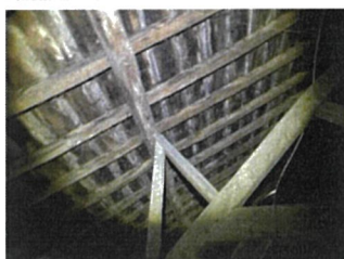
Charpente et couverture (amiante)
