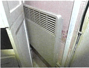
Chauffage / Radiateurs électriques
