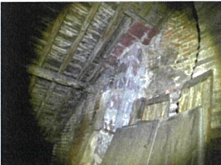
Equipements (conduits de fumée)
