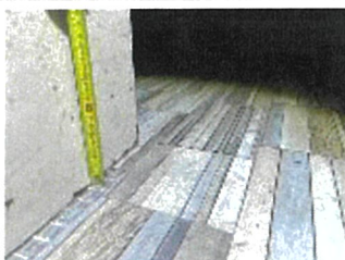
Absence de détalonnage
