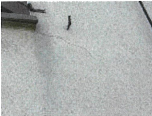
Gros œuvre et structure (fissures)
