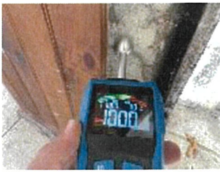
Gros œuvre et structure (humidité)
